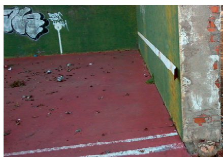
3.-Frontón sucio y peligroso.
