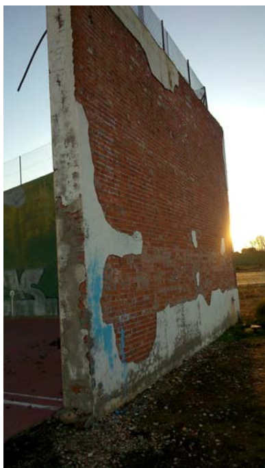
1.-Enfoscado del frontón desprendiéndose.
