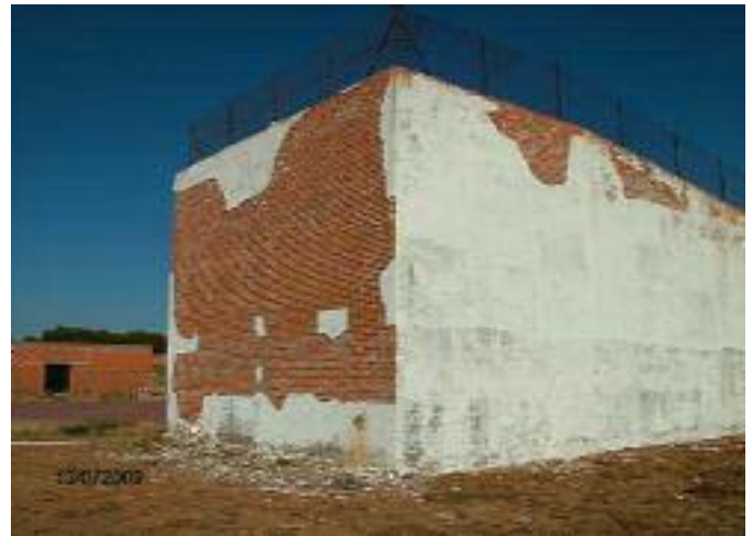
Parte trasera del frontón, con el enfoscado despredido.
